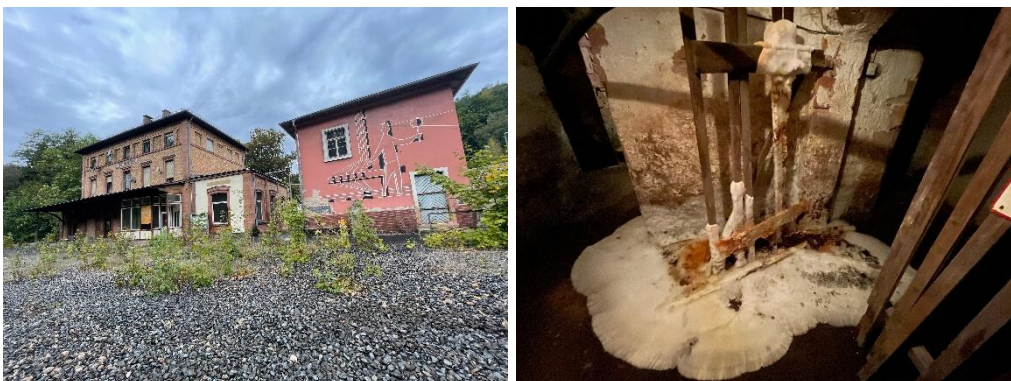
Abbildung 4, 5 Bahnhofsgebäude: links Sandsteingebäude zur Zeit der Untersuchung auf Fledermausvorkommen bewohnt; rotes Gebäude rechts baufällig und unbewohnt; Abb. 5 Schimmelpilz im Keller des bewohnten Sandsteingebäudes (S. Krebs, 26.09.23)
