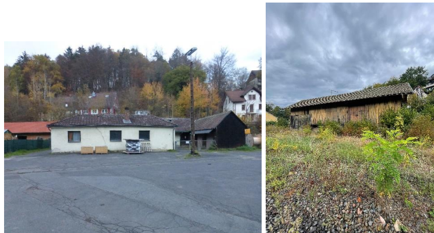
Abbildung 8, 9 Baufällige Gebäude, gelbes Gebäude rechts auf Abb. 8 wird als Lager für z.B. Streusalz genutzt. (S. Krebs, 26.09.23)
